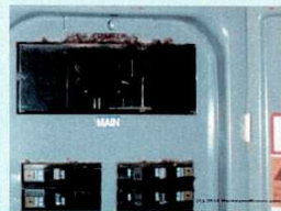
Panneau électrique rouillé
